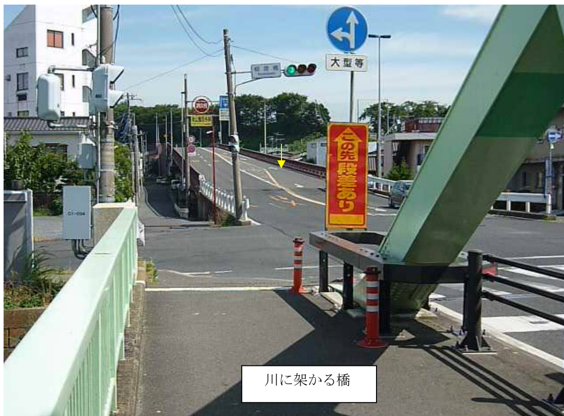
図－1 道路路面の被災の様子（盛り土舗装と陸橋の境に段差が発生）
