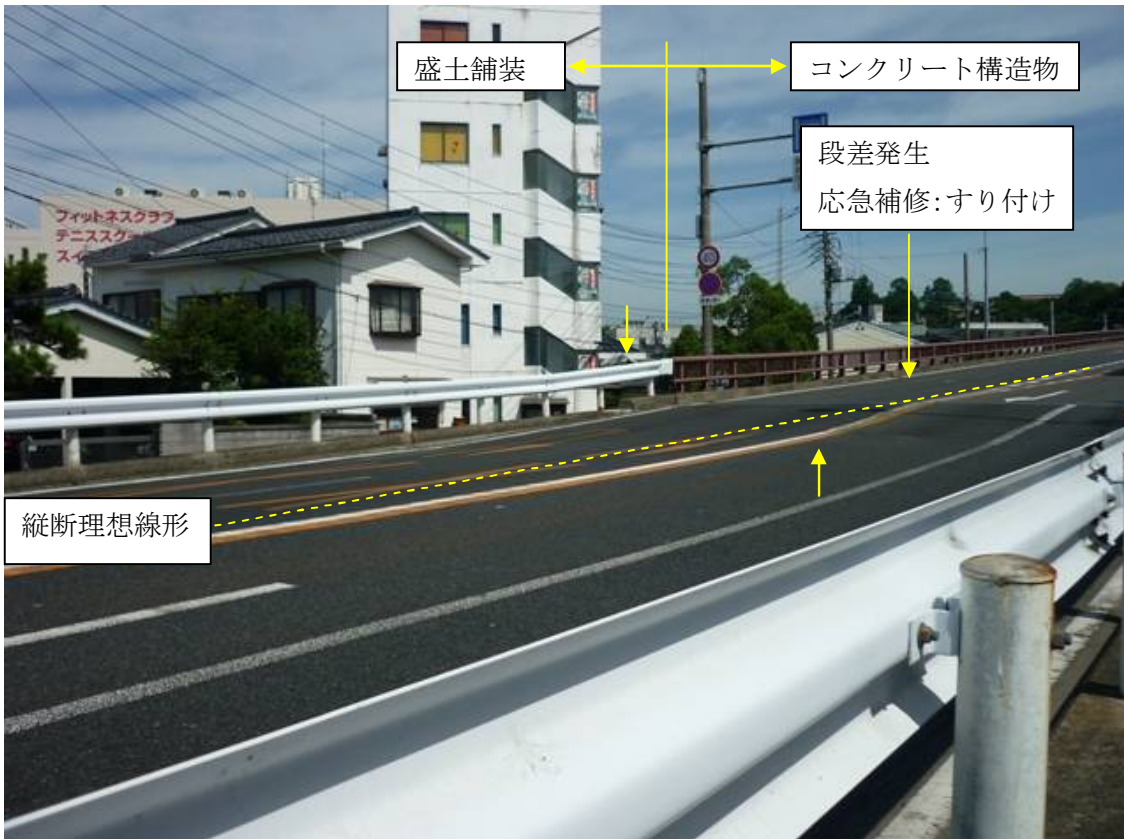
図-2 段差発生現場を側面から見る
