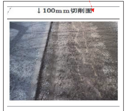
図-4 現場写真（クラック）
